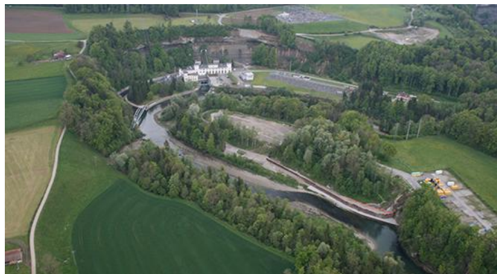
La décharge de la Pila à la fin des mesures préliminaires à l'assainissement (photo Jean-Claude Balmer, 15 mai 2014)
